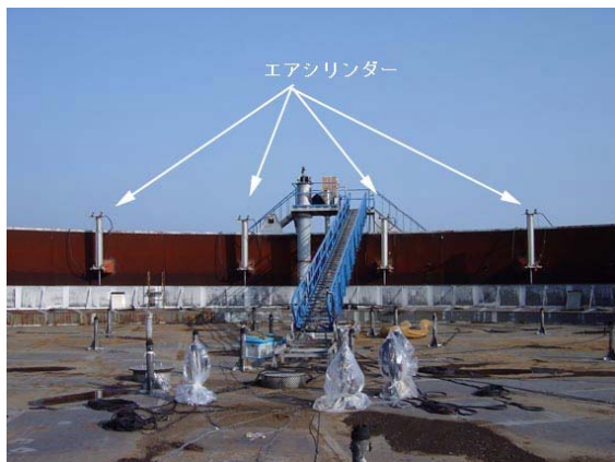
図9 15,000klタンクでのエアシリンダーを用いた浮き屋根揺動実験
