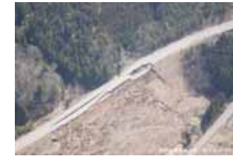
能登有料道路七尾市中島町豊田付近の盛土崩壊(国際航業(株)・バスコ, 2007)
